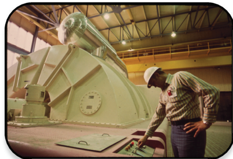
Fort St. Vrain inlet turbine
